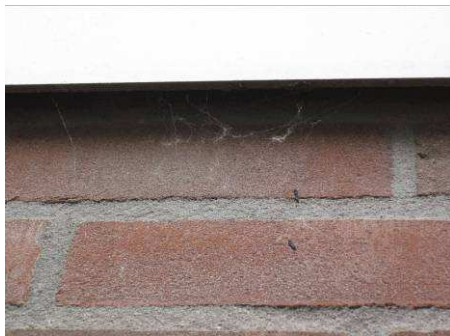
Uitwerpselen van vleermuizen onder boeiboord van te slopen stal.
