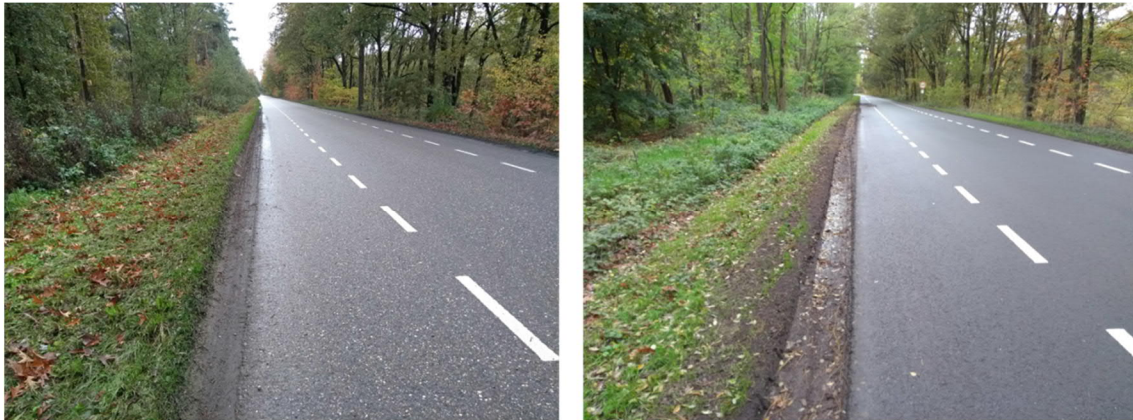
Figuur 4: Bermschade Kanaaldijk Zuid-Terraweg
