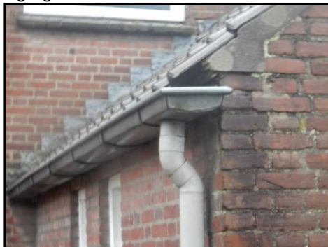
Figuur 10. Geschikte openingen voor huismussen onder de onderste rij dakpannen.
