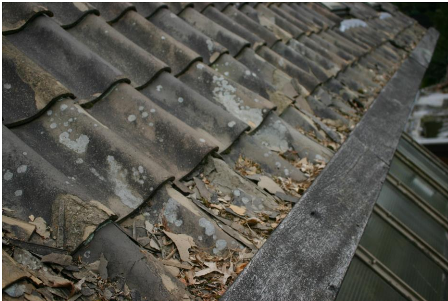
Figuur 4.4.1.. Door de aanwezigheid van een houten plank (en afwezigheid van een goot) voor de onderste rij dakpannen van het buitenverblijf, is er hier geen toegang voor vogels.
