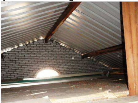
Impressie aansluiting muur op het dak: binnenzijde. Het dak in de nok is niet geïsoleerd.
