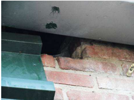
Opening zijkant schuur waar een paar-tje houtduiven in is geconstateerd.
