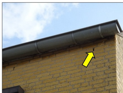
Figuur 5.3 Open stootvoegen die vleermuizen toegang geven tot de spouwmuur.
