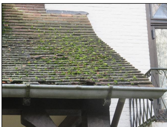
Foto 9. Detail van dakpannen en loodslabben
