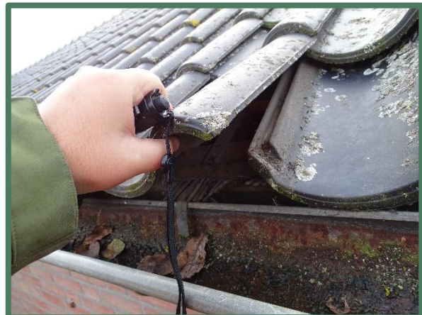
Vogelschroot onder de dakpannen
