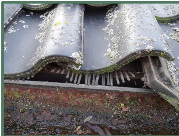
Vogelschroot onder de eerste rij dakpannen
