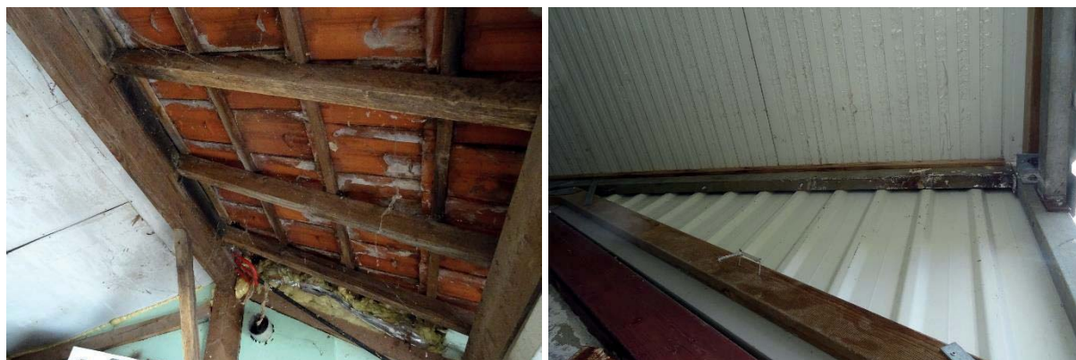
Afbeelding 5 en 6: Deels enkel dakplaten en dakpannen zonder dakbeschoot. Overige delen niet toegankelijk/ te laag (+/- 175 cm invlieghoogte) voor huismussen. Bron: BNL advies, datum: 30-05-2022
