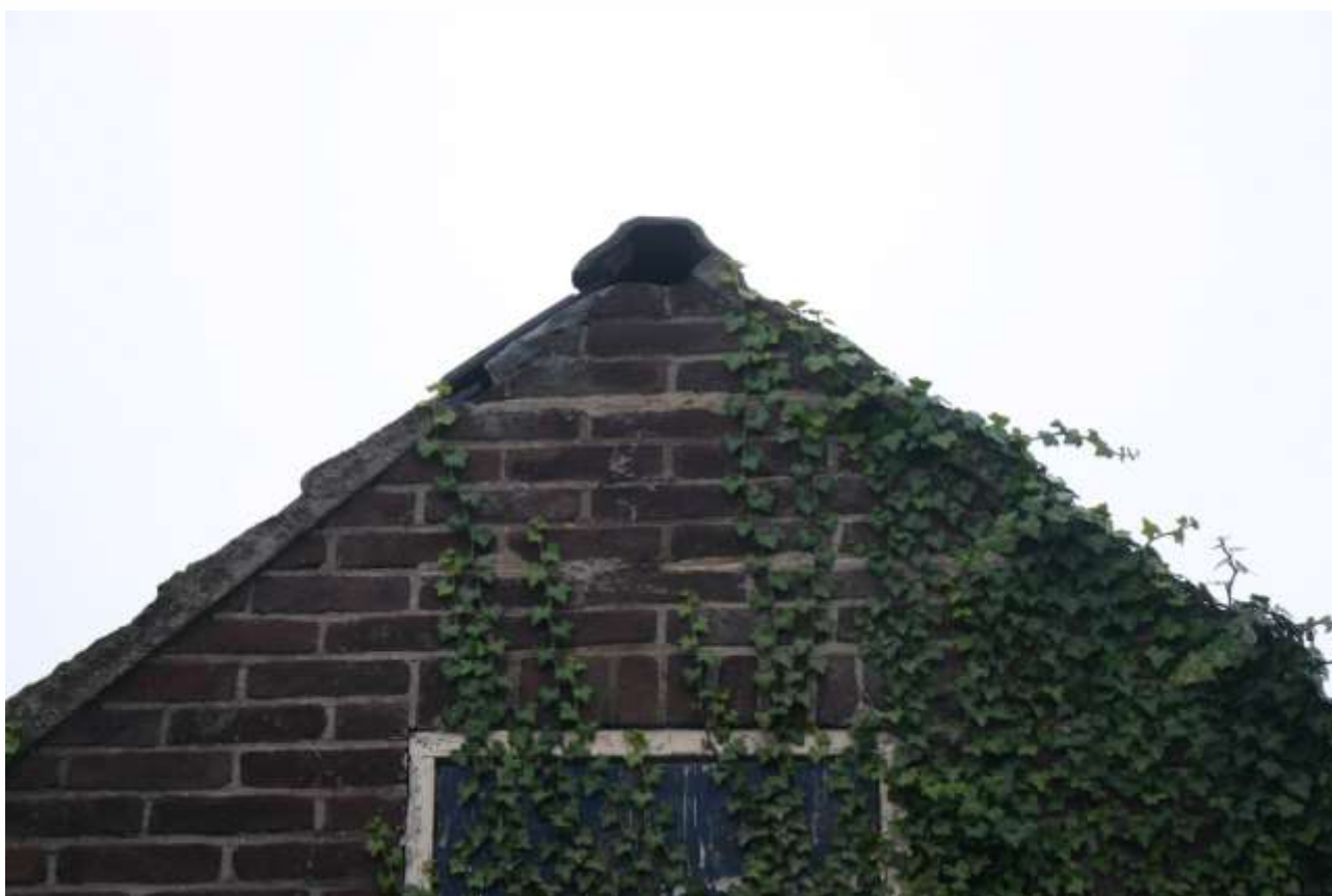
Figuur 4.4.5. De dakpannen liggen niet overal in de specie en de nok is ook open. Vleermuizen, huismussen en gierzwaluwen hebben hier toegang tot de spouw of de ruimte onder de dakpannen.
