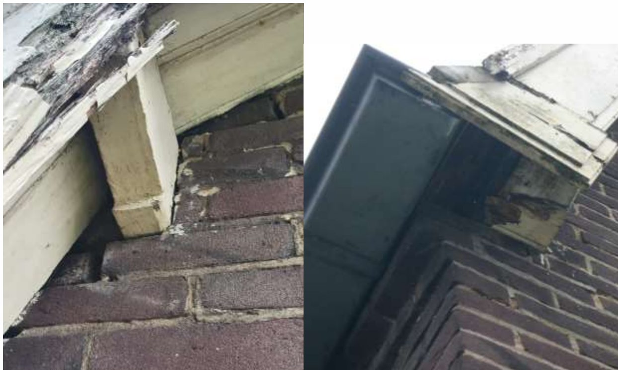
Figuur 4.4.4. Onder het dakoverstek zijn op meerdere plekken spleten en gaten aanwezig waardoor vleermuizen de spouw kunnen bereiken.
