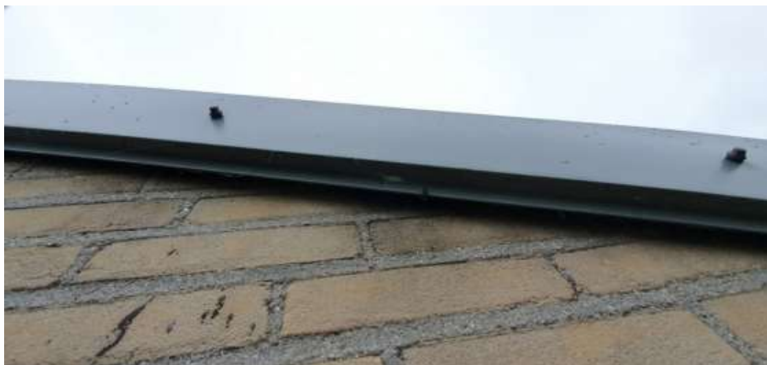
Figuur 4.4.2. De windveer aan de achtergevel kiert waardoor vleermuizen de spouw kunnen bereiken.
