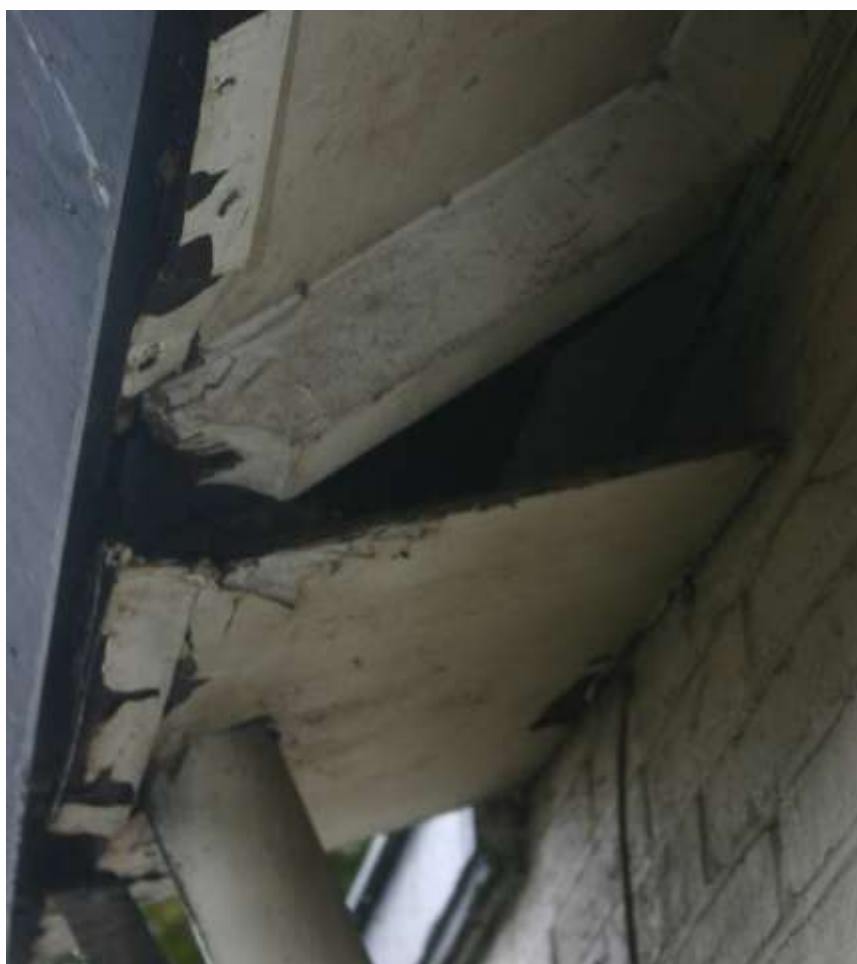
Figuur 4.4.6. Op één plek onder het dakoverstek hangt een plaat aan de onderzijde, maar hier is geen geschikte (directe) aanvliegroute voor vleermuizen of gierzwaluwen.
