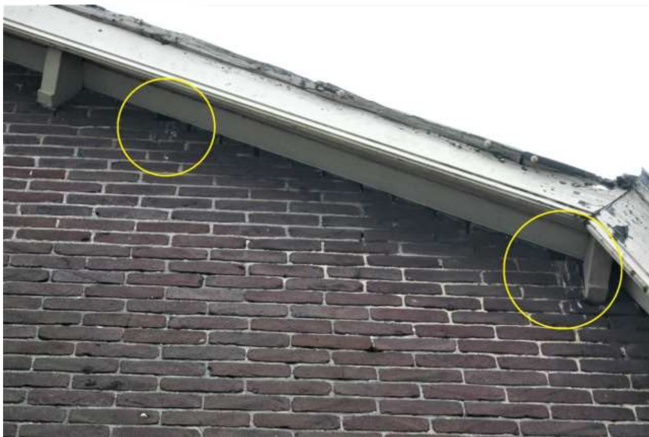
Figuur 4.4.3. Onder de daklijst zijn gaten aanwezig met vogeluitwerpselen op de muur (gele cirkels). Ook zijn er meerdere spleten onder de daklijst aanwezig waardoor vleermuizen de spouw kunnen bereiken.
