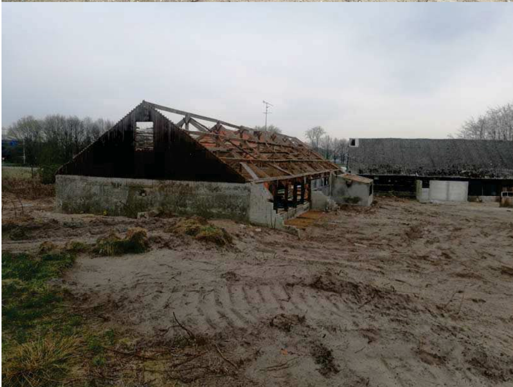
Foto's van de onderzoekslocatie – d.d. 2 april 2019
