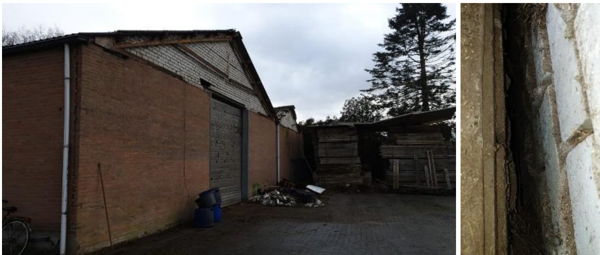
Afbeelding 5 en 6: Te slopen loods aan de Bergdijk 4 in Someren zijn gecontroleerd op de mogelijke aanwezigheid van geschikte vaste rust- en verblijfplaatsen van vleermuizen. De spouwmuren zijn vanaf de bovenzijde open, waardoor weersinvloeden vrij spel hebben en het voor vleermuizen niet geschikt is. Bron: R.J.L. Bijvelds Datum: 17-03-2021
