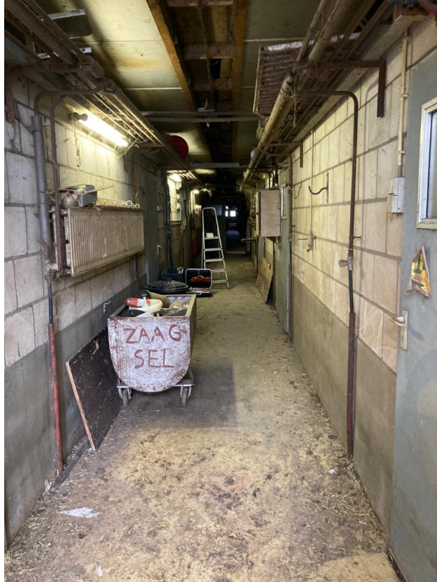
• Afbeelding 15: binnenzijde varkensstallen
