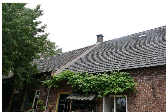
Figuur 10 Aan de achterzijde steekt de brandgevel nog door het dak, zoals op de bouwtekeningen.
