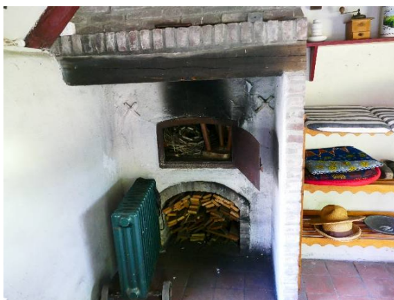
Figuur 27 De ovenmond met rookvang bevindt zich in een hoek van het gebouw.
