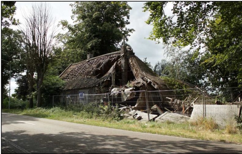
Figuur 1. Foto van de vervallen woning aan Kerkendijk 60.
