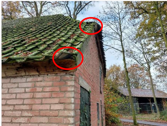
Figuur 5.2 Openingen bij dakpannen en de dakrand van opstal 1.
