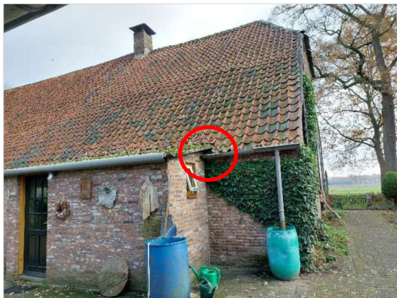
Figuur 5.4 Openingen bij de dakpannen bij opstal 2.
