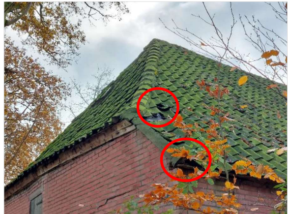
Figuur 5.3 Missende en scheefliggende dakpannen en openingen bij de dakrand van opstal 1.
