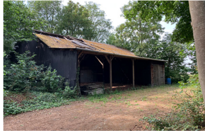
Vervallen stalling in het bosje aan de overzijde van de Wolfsdreef.
