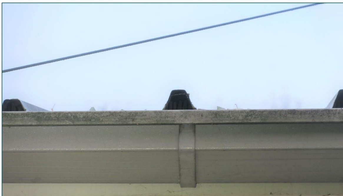
Figuur 3.2 Vogelwering onder de metalen damwandplaten. De ruimten onder het dak zijn niet toegankelijk voor huismussen.
