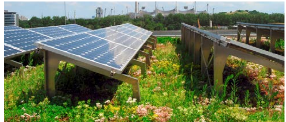
Groene daken vangen het water op, dragen bij aan biodiversiteit en verminderen hittestress en kunnen gecombineerd worden met zonnecellen
