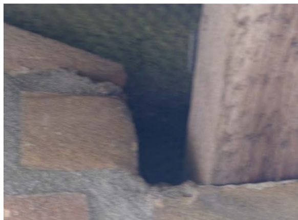
Foto 4. Opening tussen dak en zijgevel
