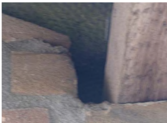
Foto 4. Opening tussen dak en zijgevel
