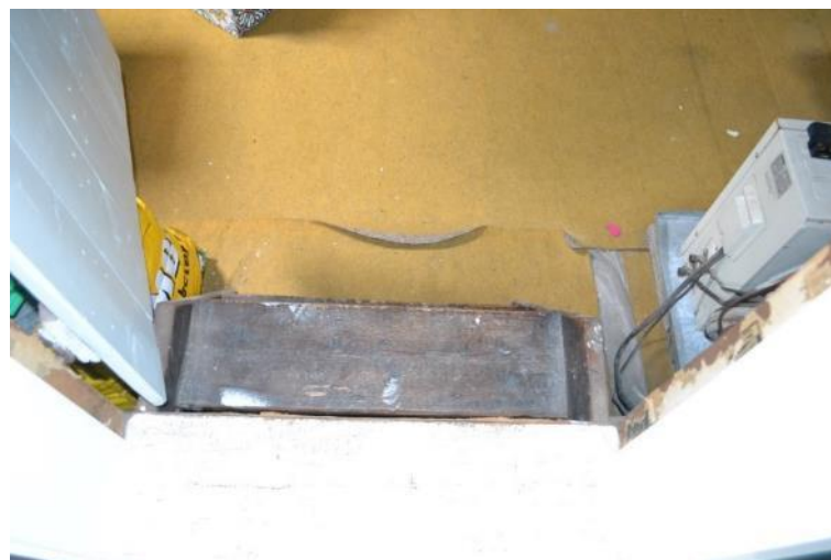
Hoogte verschil doorgang door brandmuur.
