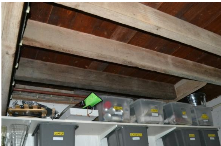
Afwijkingen in verdiepingsvloer, voormalige trap naar hooizolder.
