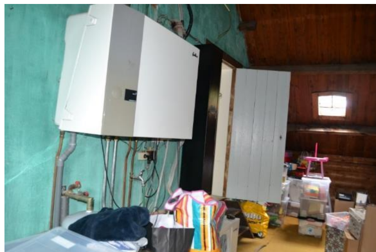
Doorgang door en CV tegen brandmuur.
