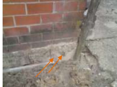
Afgebroken stukjes asbest golfplaat
