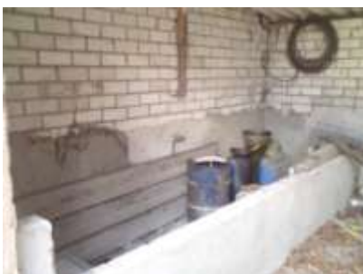
Lekbak van voormalige dieselolietank met nog enkele olievaten
