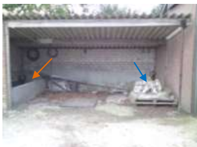
Open berging met de lekbak van de voormalige dieselolietank Zak met stukjes asbesthoudend materiaal
