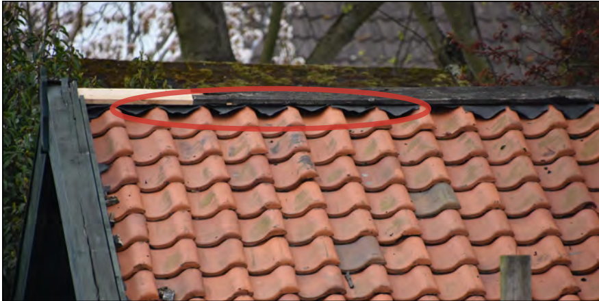
Figuur: er zijn openingen aanwezig in het dak van de tuinhuisjes (rode cirkel). Hierdoor kunnen vleermuizen ruimtes in het dak bereiken waar ze verblijfplaatsen kunnen hebben.
