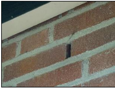
Figuur 21. Gebouw 1, open stootvoeg die toegang geeft tot de spouwruimte.
