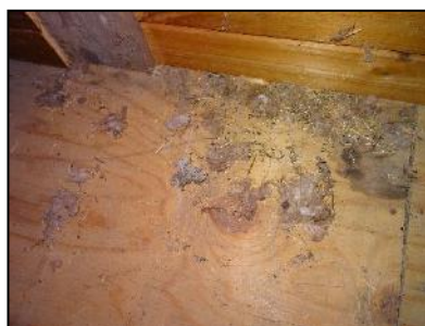
Figuur 8. Gebouw 1, verzameling spouwisolatie, takjes en verschillende soorten uitwerpselen in zolderruimte.
