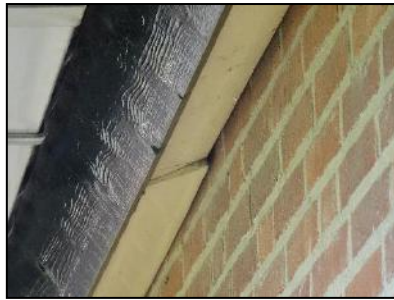
Figuur 22. Gebouw 1, spleten bij het timmerwerk geen toegang tot ruimtes achter de betimmering.
