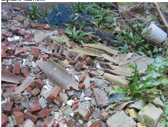
Foto uit asbestinventarisatie: Asbest en tongvaren.
