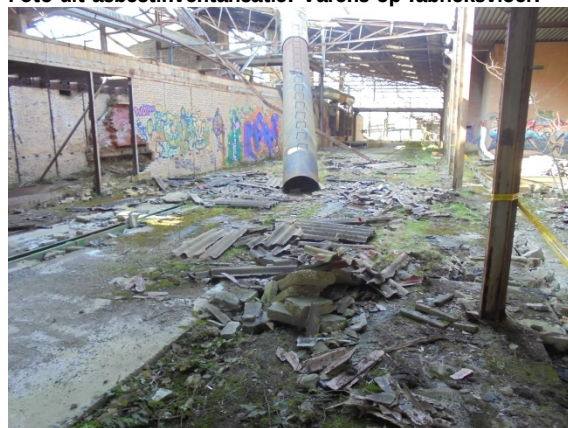
Foto uit asbestinventarisatie: ingestort dak, asbest op de vloer.
