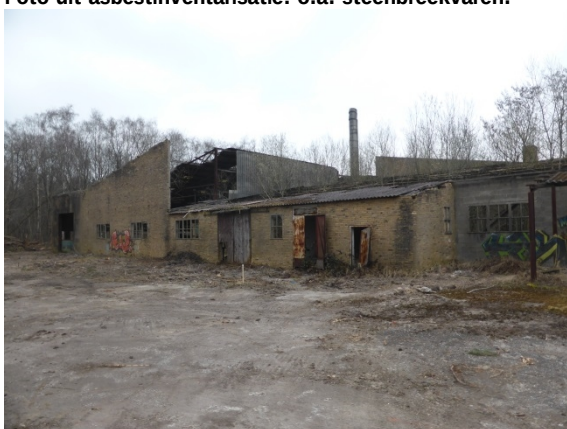
Achterkant fabriek met ingestort dak, en bomen inpandig.
