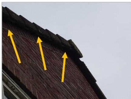
Foto 22: Dakrand kopse zijde (mogelijke toegang vleermuizen) Hoefstraat 12 te Zegge.
