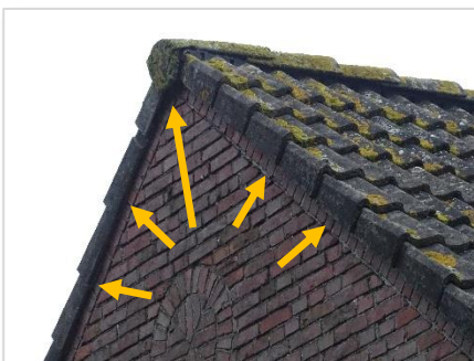
Foto 20: Dakrand kopse zijde (mogelijke toegang vleermuizen) Hoefstraat 12 te Zegge.
