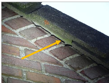
Foto 23: Dakrand kopse zijde (mogelijke toegang vleermuizen) Hoefstraat 12 te Zegge.
