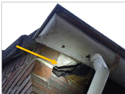
Foto 24: Dakrand kopse zijde (mogelijke toegang vleermuizen) Hoefstraat 12 te Zegge.
