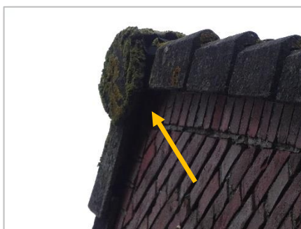
Foto 21: Dakrand kopse zijde (mogelijke toegang vleermuizen) Hoefstraat 12 te Zegge.
