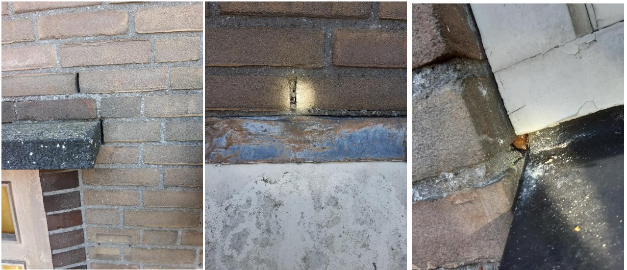
Figuur 4.1: Links, toegankelijke spouwen en opening bij voordeur. Midden, Verstopte stootvoeg. Rechts, gat nabij raamkozijn met daarachter isolatiemateriaal.
