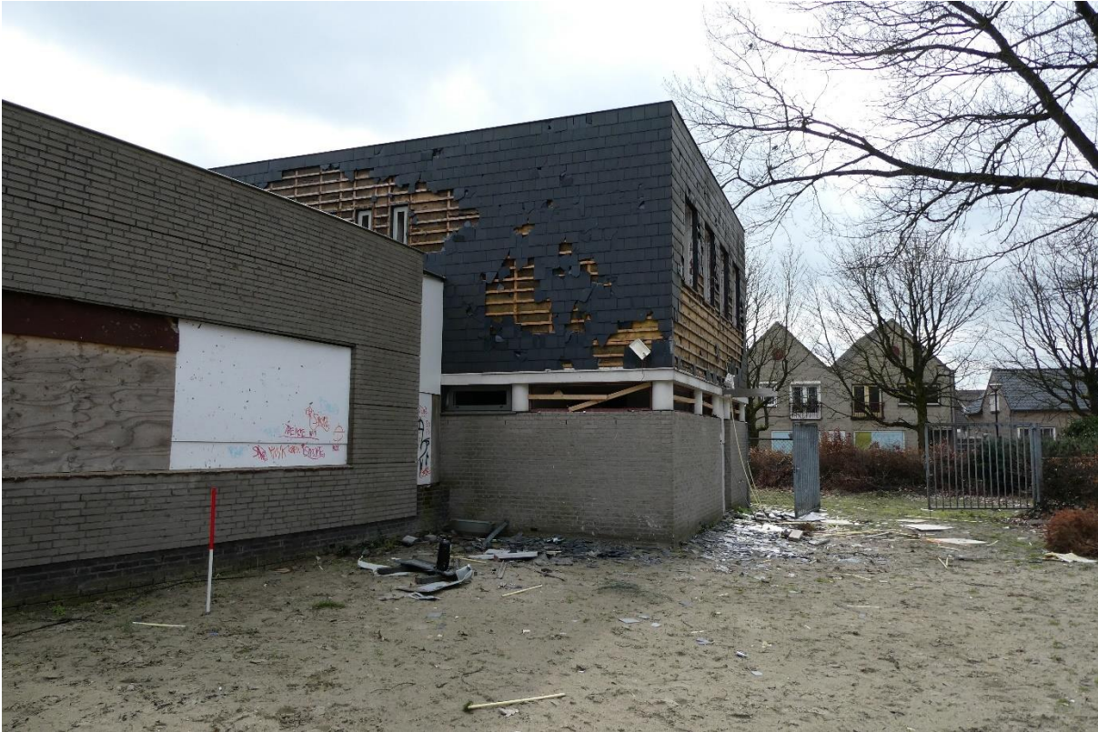
Afbeelding 5. Noordwestelijk aanzicht op de uitbouw van het pand. Door baldadigheden zijn diverse zones van de gevelbetimmering met leities verwijderd en is de onderliggende, houten draagconstructie bloot komen te liggen.
