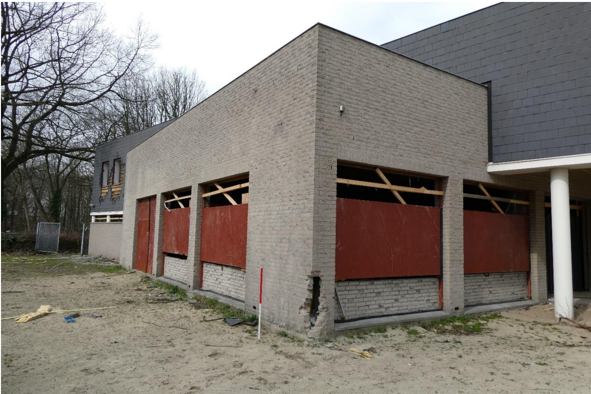
Afbeelding 4. Aan een hoek van de zuidoostelijke zijde van het pand bevond zich een gat van circa 1 meter groot en circa 12 centimeter breedte in de muur. De spouw was zichtbaar.
