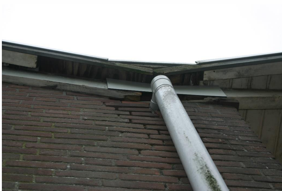
Figuur 4.4.1. De houten dakbetimmering is rot en kiert met de gevel, daktrimmen kieren en voegwerk ontbreekt op meerdere plaatsen. Vleermuizen kunnen op diverse manieren de bebouwing in.
