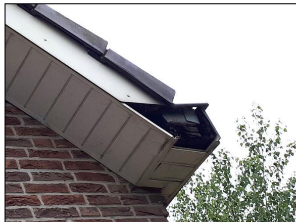
Figuur 10. Gaten in het boei-boord bieden potentieel geschikte ruimte voor gierzwaluwen en vleermuizen en eventueel een steenuil.
