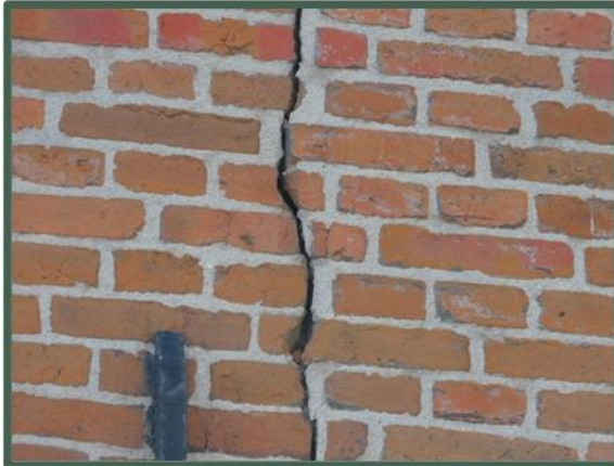
Scheur in de muur
