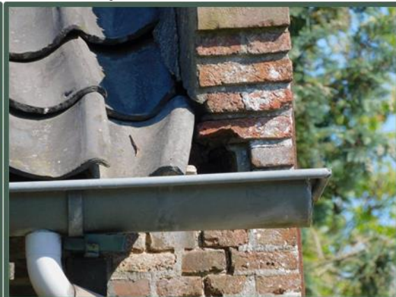
Gat in de muur, ruimte onder dakpan
