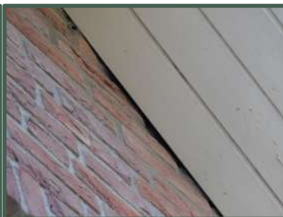
Ruimte tussen muur en betimmering
