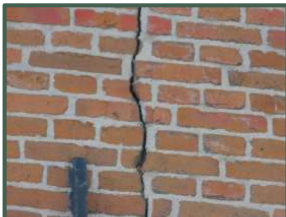
Scheur in de muur
