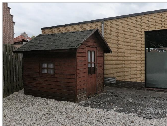
Foto 15: Ogenscheinlijk nog intact, maar door houtrot aan onderzijde reeds vervallen tuinhuisje achter het overdekte zwembad.
