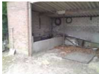
Stallingsruimte met lekbak voor voormalige bovengrondse dieselolietank
