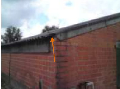
Beschadigde asbest golfplaat aan noordoostzijde van de veestal
