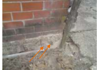
Afgebroken stukjes asbest golfplaat
