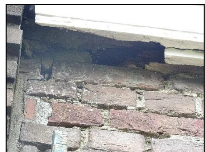
Figuur 8. Detail ruimte in muur onder boeiboord woonhuis.
