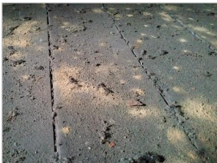
Foto 26: Tussenzolder (stoflaag en zaagsel houtworm)
