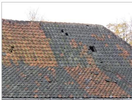
Foto 139: Noordzijde slooppand met vervallen dak
