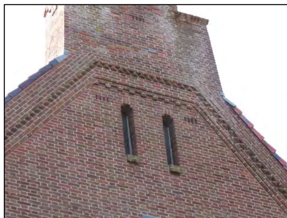
Foto B: kerk: overhellende dakpannen en ventilatieroosters
