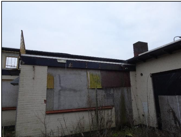
Figuur 9. Loshangende dakranden en ruimtes achter betimmeringen bieden verblijfplaatsen voor vleermuizen.
