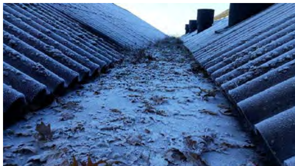
Schuur, bitumineus materiaal in goot, niet asbestverdacht
