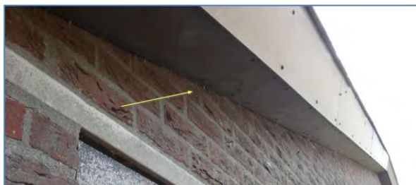
Foto 19 strakke afdichting gevel W gebouw 4
