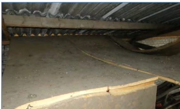
Foto 20 loshangende isolatieplaten gebouw 2
