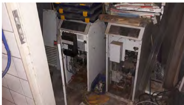
Schuur, Radson installaties, asbestvrij conform handboek Intechnum
