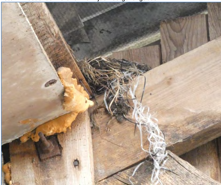
Foto 8 oud merelnest 'binnenzijde' achtergevel gebouw 2
