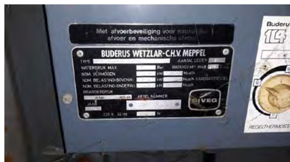
Stal 2, Buderus Loganagas 104 installaties uit 1992, niet asbestverdacht conform handboek Intechnium
