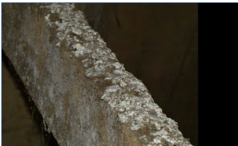
Foto 25 beschimmelde oude resten mengvoer op binnen-spant
