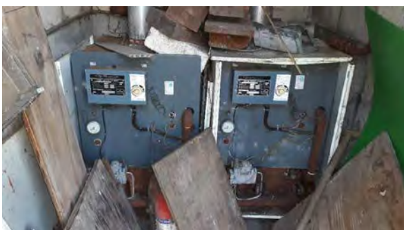
Stal 2, Buderus Loganagas 104 installaties uit 1992, niet asbestverdacht conform handboek Intechnium
