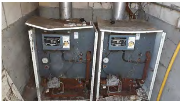
Stal 2, Buderus Loganag 104 installaties uit 1992, niet asbestverdacht conform handboek Intechnum
