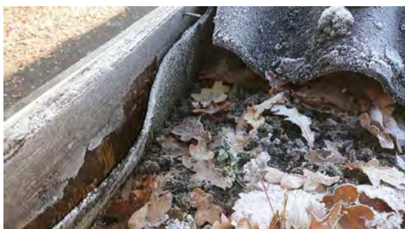
Schuur, bitumineus materiaal in goot, niet asbestverdacht
