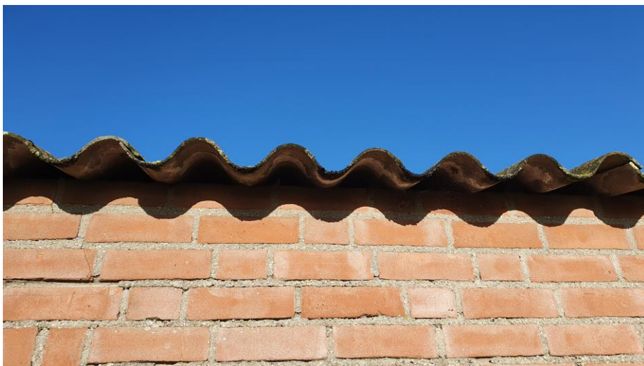
Figuur 4.2.2. Een goot ontbreekt en vogelschroot en een muurplaat zijn afwezig.
