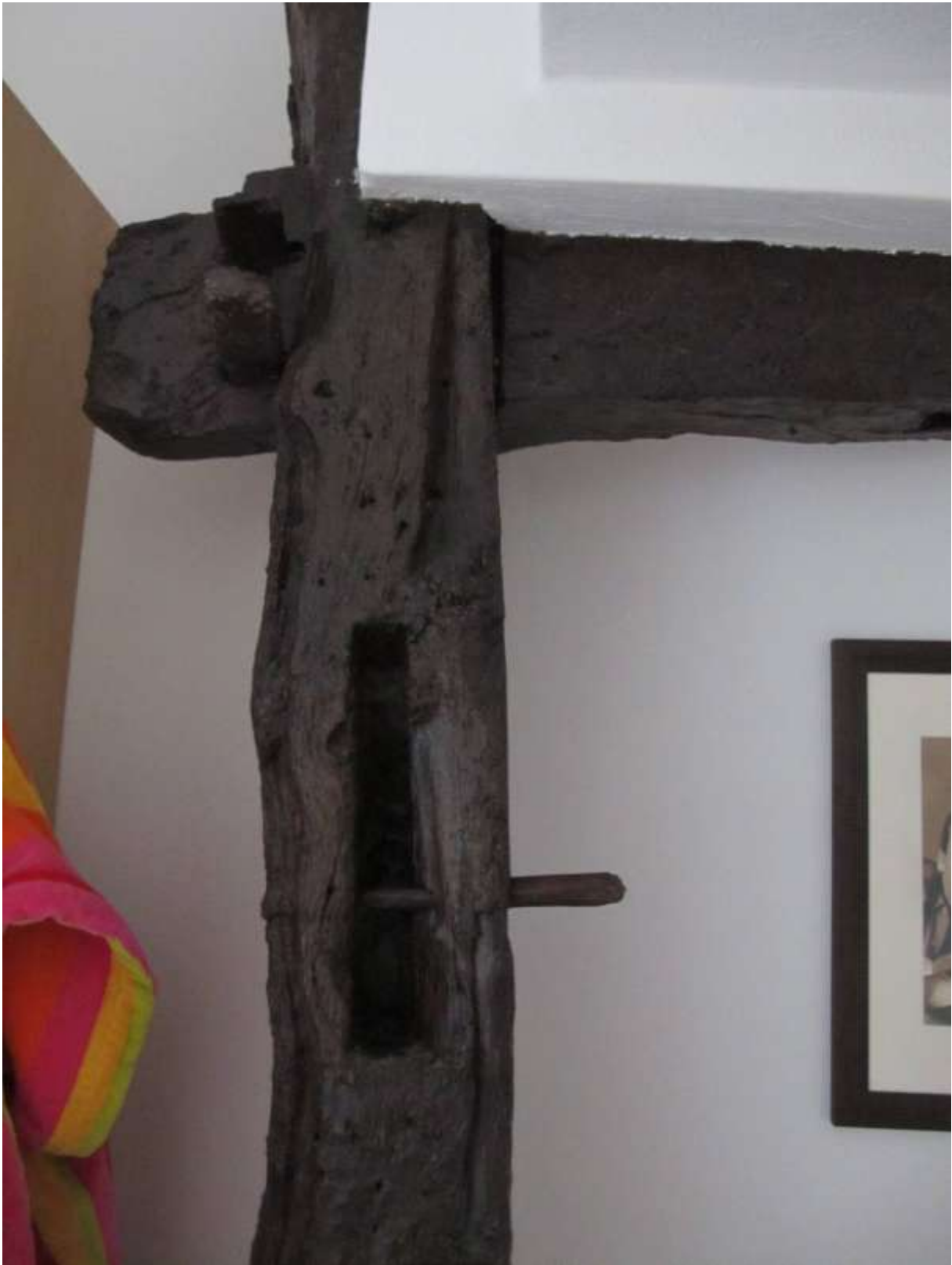
Detail van de noordelijke gebintstijl en ankerbalk van het oostelijke gebint FH MAB 2012
