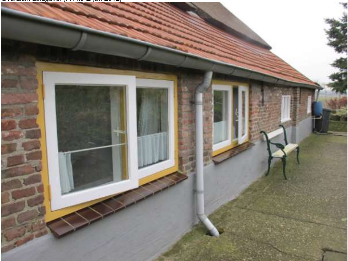
Zicht langs de noordgevel die naar de dijk is gericht. FH MAB jan 2012
