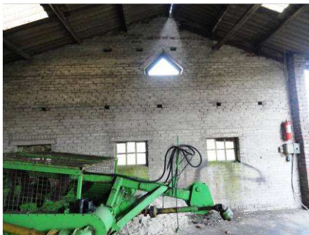
Detail binnenzijde werkloods: spouwmuur met grote openingen aan zowel binnen als buitenzijde en boven raamkozijnen.
