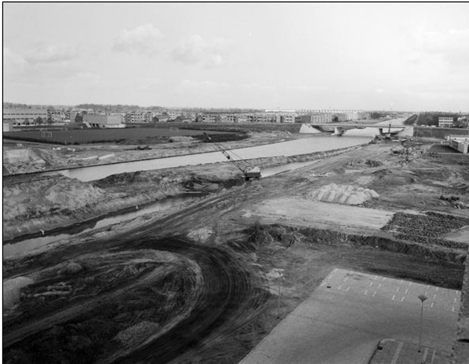
Afb. 10.- Foto van het onderzoeksgebied richting de Weststadbrug tijdens de aanleg van het nieuwe sluisencomplex d.d.7-3-1973 (bron:beeldbank Rijkswaterstaat).
