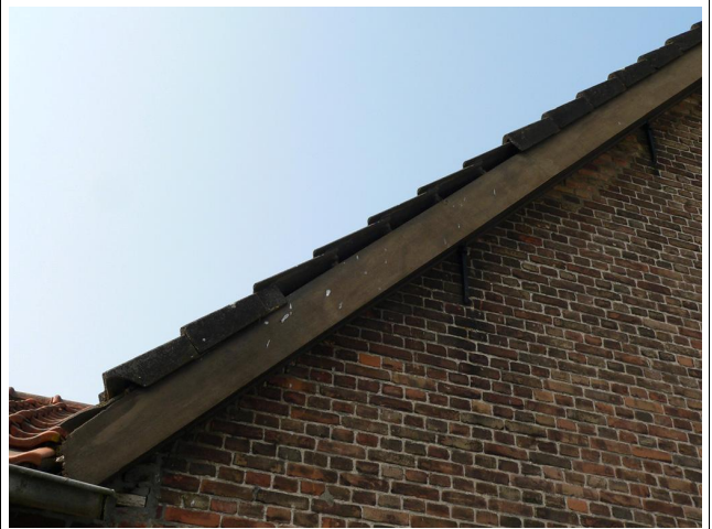
Ontbrekende gevelpannen en vogelsporen.
