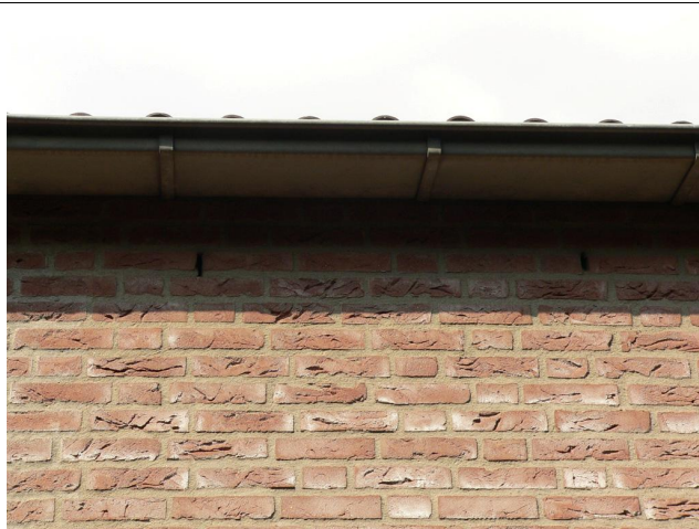
Open stootvoegen zuidgevel opslagloods
