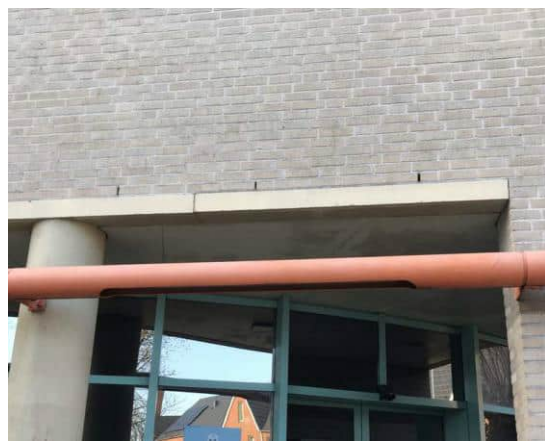
Afbeelding 13. Er zijn in het gebouw meerdere open stootvoegen aanwezig
