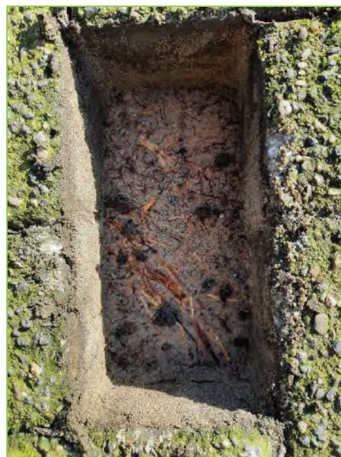
Oppervlakkige beworteling direct onder de klinker bij boom 14.
