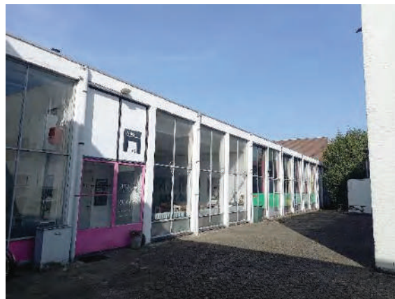
Foto J: Abdis van Thornstraat 68 en 68a (ruimte onder metalen daklijst)
