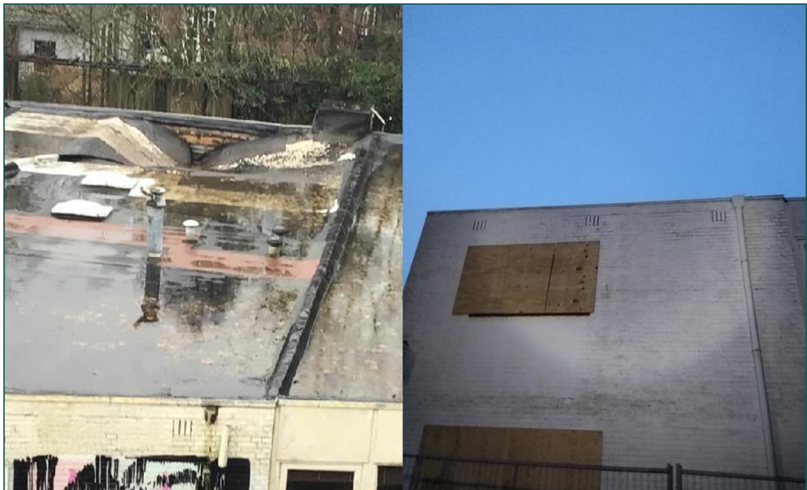
Figuur 4.1 De bebouwing is in een slechte staat. Een deel van het dak van het gebouw is ingestort (links) en voor alle ramen zijn houten platen aanwezig (rechts).
