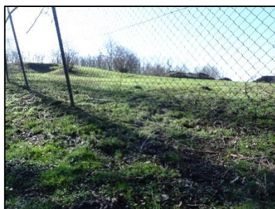
Figuur 7. Het hekwerk rondom het terrein. Zichtbaar is dat het hekwerk aan de onderkant open is.
