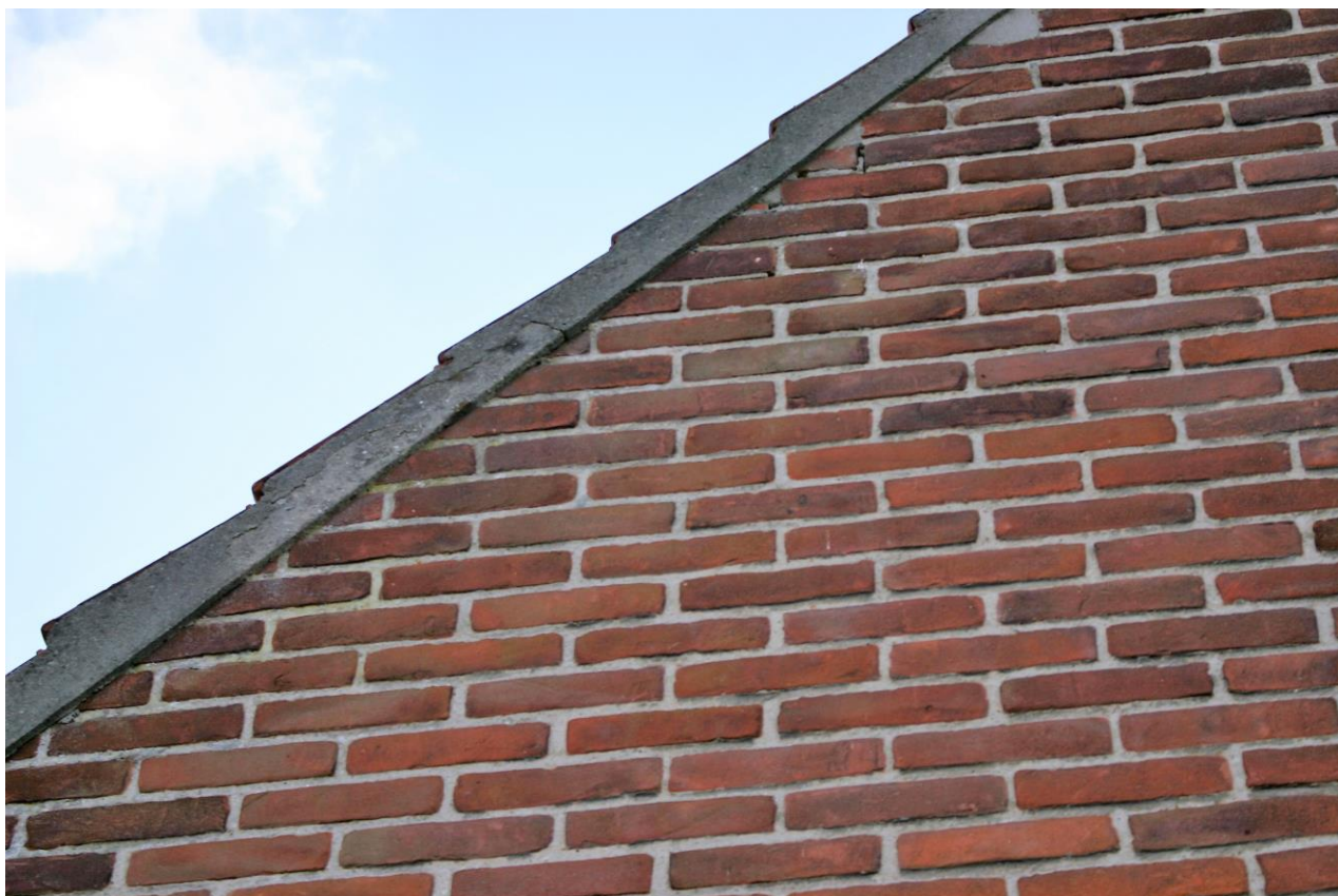
Figuur 4.2.2. De gevelpannen van het woonhuis liggen in specie.
